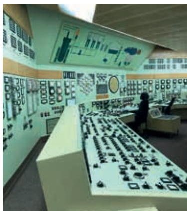
Schaltwarte des Kernkraftwerks Rheinsberg 2018 Foto: Jüttemann
